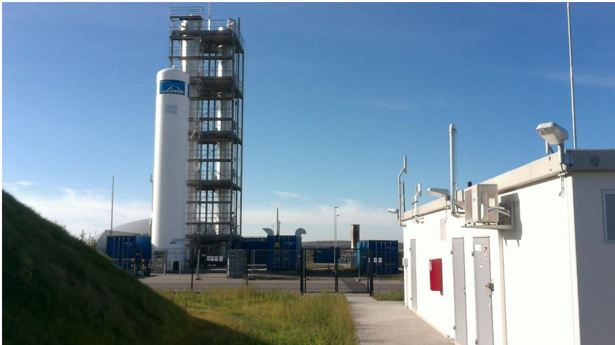
Biogasaufbereitungsanlage des PFI (hinten links) und Biogaseinspeiseanlage der Stadtwerke Pirmasens (vorne rechts) im Energiepark Pirmasens-Winzeln
