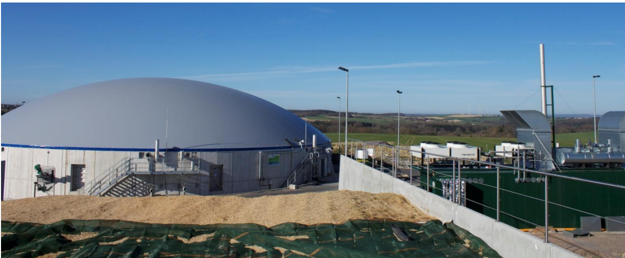
Abb. 3: Behälter und Blockheizkraftwerk
